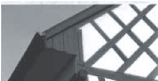
Richtig: Traufuntersicht bündig mit Giebelfassade
